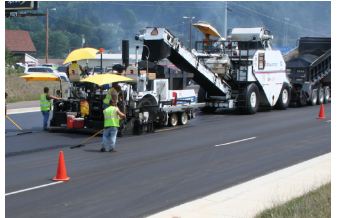
Shuttle Buggy ile Termal ve Fiziksel segregasyonun önlenmiş olduğu asfalt serim yüzeyi.
