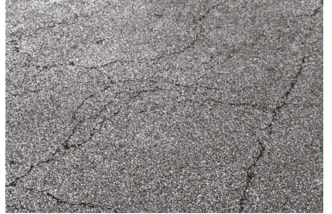
Termal segregasyonlu asfalt yüzeyi
